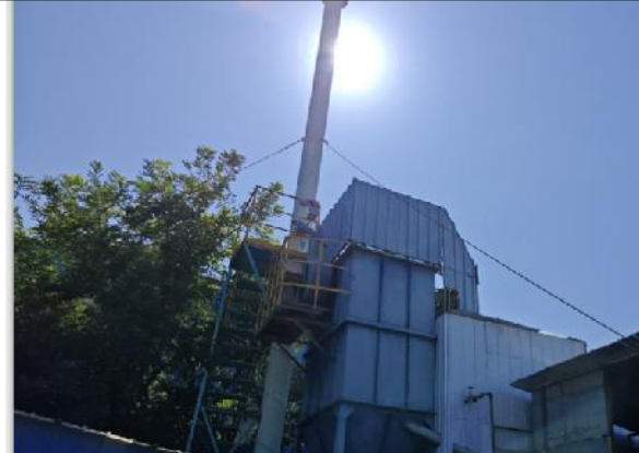
DA054-改造后（上移采样口，直梯改斜梯，加高排气筒，安装固定电源）
