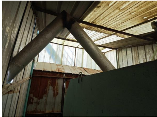
产尘点位封闭集气措施到位
