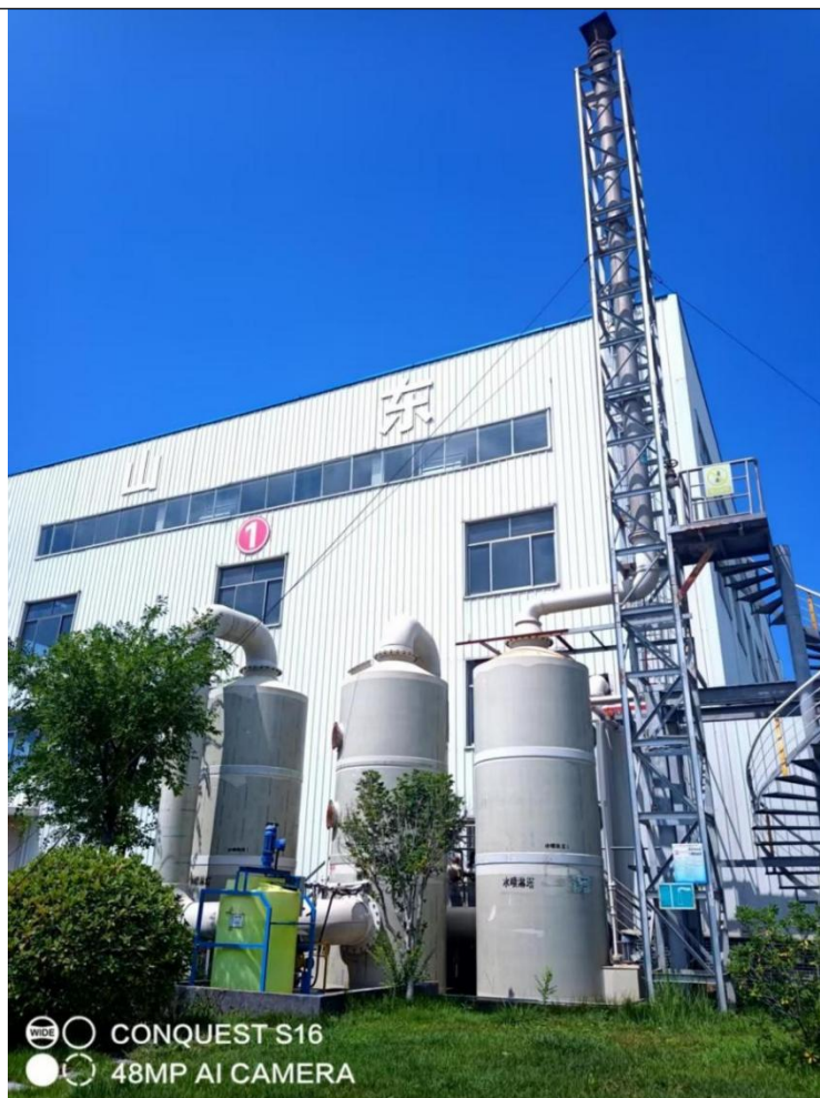
DA002 排气筒及废气处理设施
