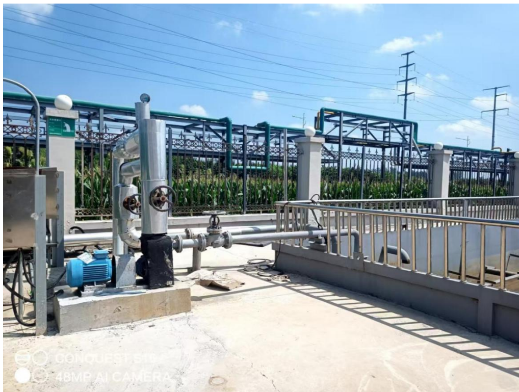
图 2.3-6：厂区污水排放口
