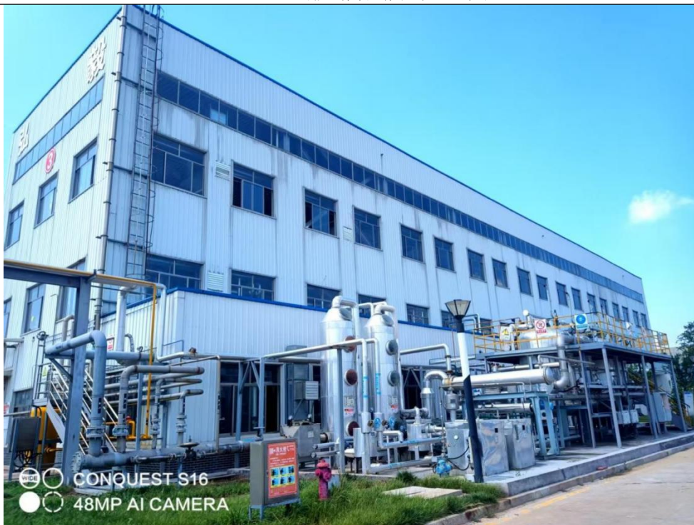
DA003 排气筒及废气处理设施
