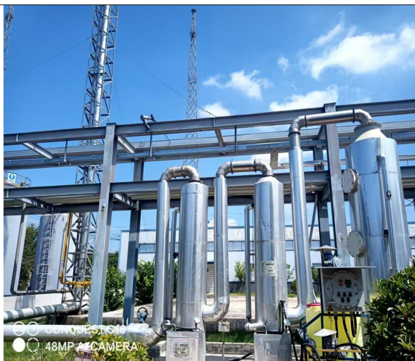
DA001 排气筒及废气处理设施
