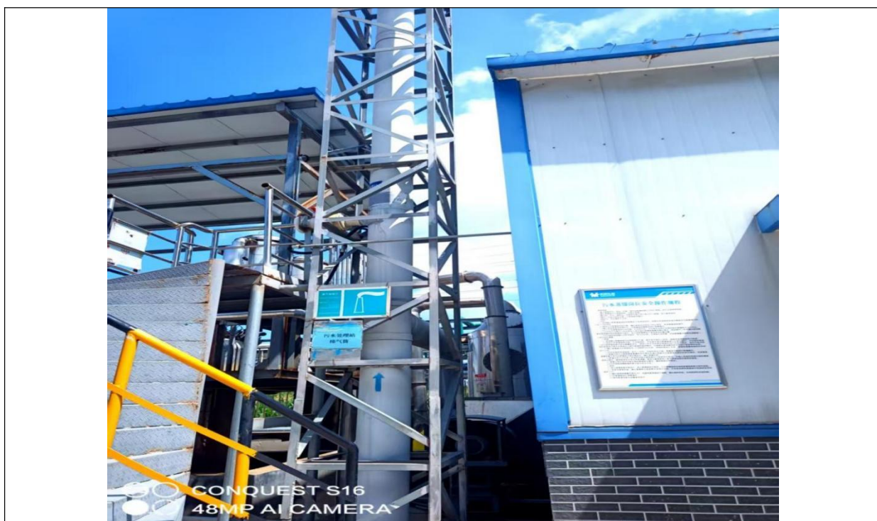
DA004 排气筒及废气处理设施
