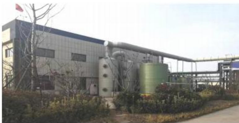
(RTO 装置前) 废气喷淋塔 (2 座碱喷淋塔、2 座水喷淋塔)
