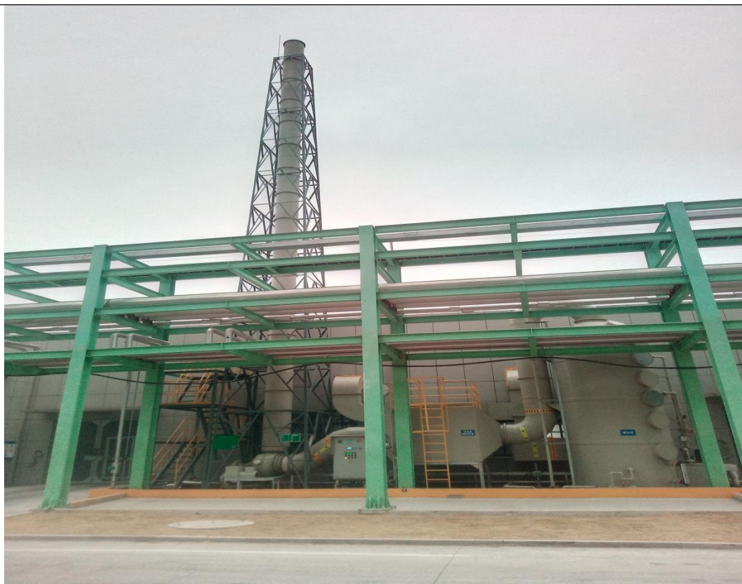
DA005 排气筒及废气处理设施
