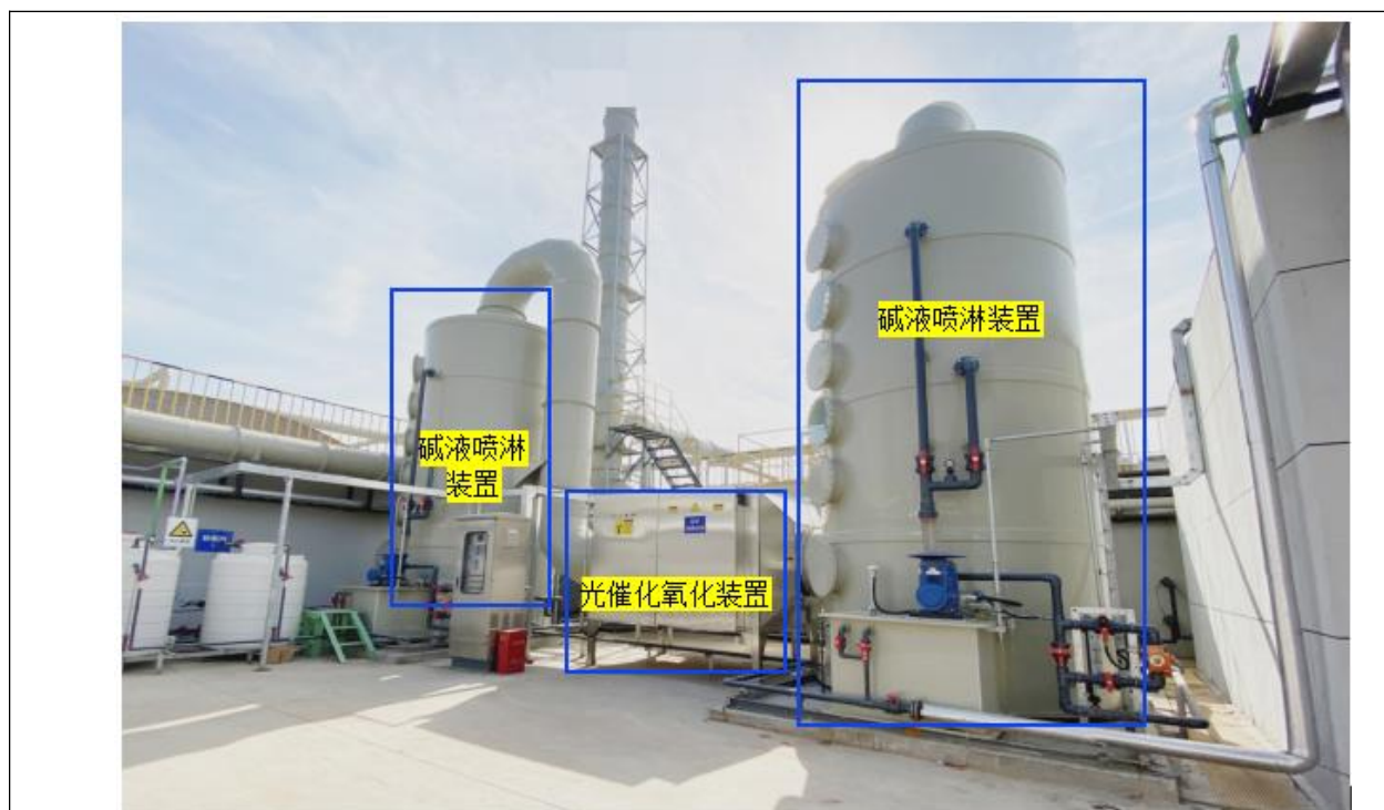
DA006 排气筒及废气处理设施
