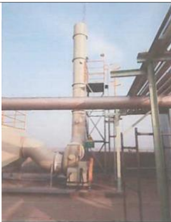
DA004 排气筒及废气处理设施
