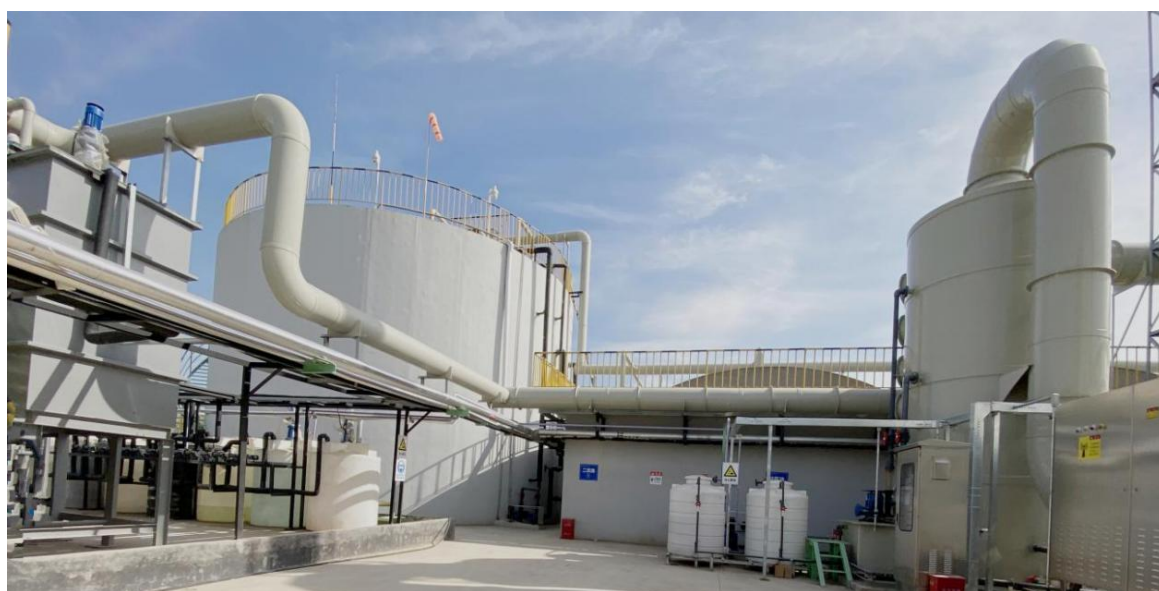
图 2.2-7 东厂区污水处理站
