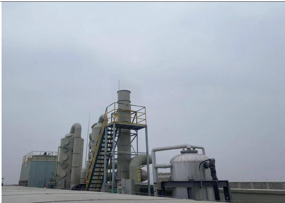
DA003 排气筒及废气处理设施
