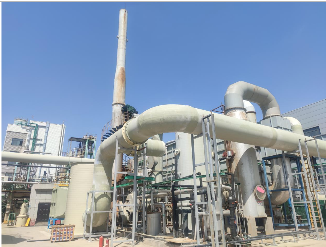
DA001 排气筒及废气处理设施
