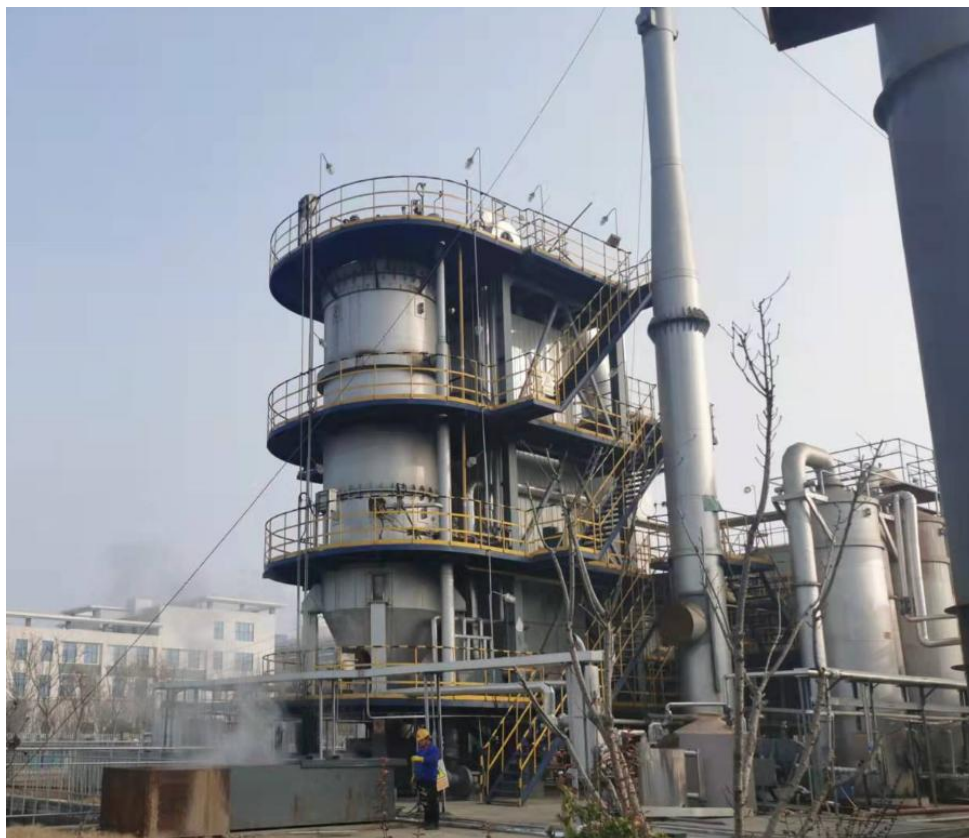
图 2.2-10 西厂区废液、高浓废水处理设施（焚烧炉）
