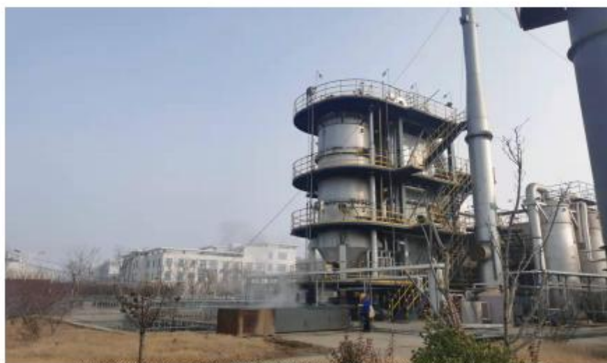
废液焚烧炉及其废气处理设施、排气筒 (DA010)
