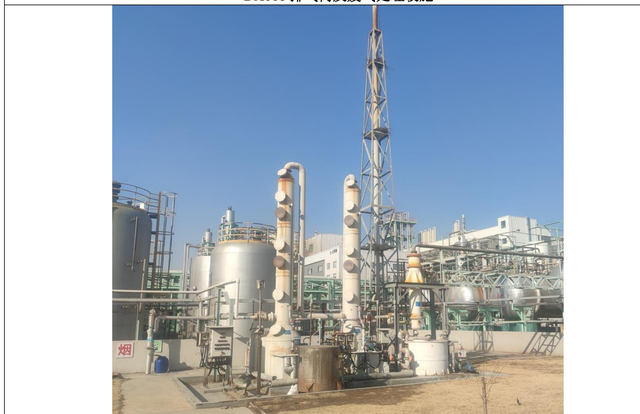
DA007 排气筒(盐酸罐区)
