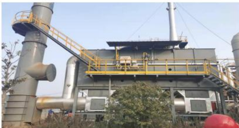
RTO 废气治理设施及排气筒 (DA009)
