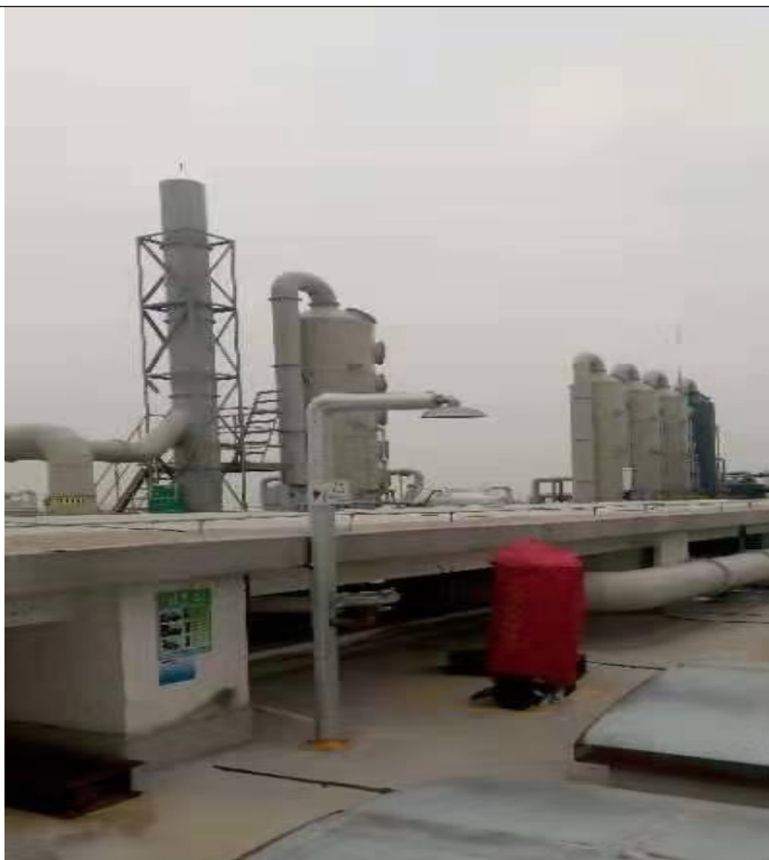
DA002 排气筒及废气处理设施
